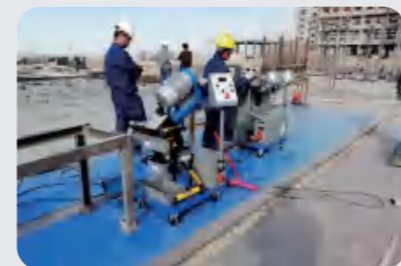
客户现场 Customer site
